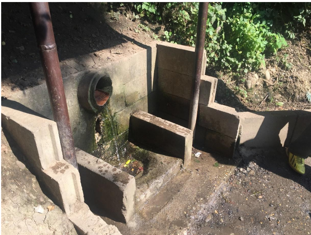
Zdroj pitnej vody v osade „Pod Kortínou“ v Žiari nad Hronom
