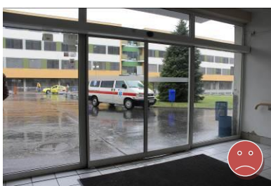
Sklenené vstupné dvere, slabo označené (NR)
