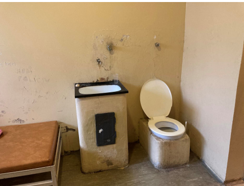
OO PZ Poprad: sanitárne zariadenie v cele (potreba rekonštrukcie)
